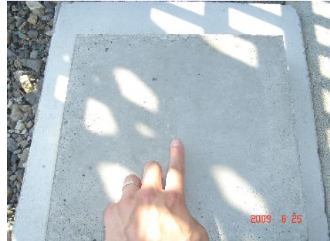
指から右側が施工面、会社敷地内に置いて経過を確認する。
